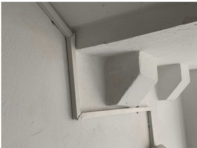
Obr. 3: Elektrické inštalácie k osvetleniu
