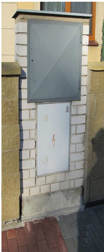
Obr. 8: Umístění HDS na sloupku v plotě
