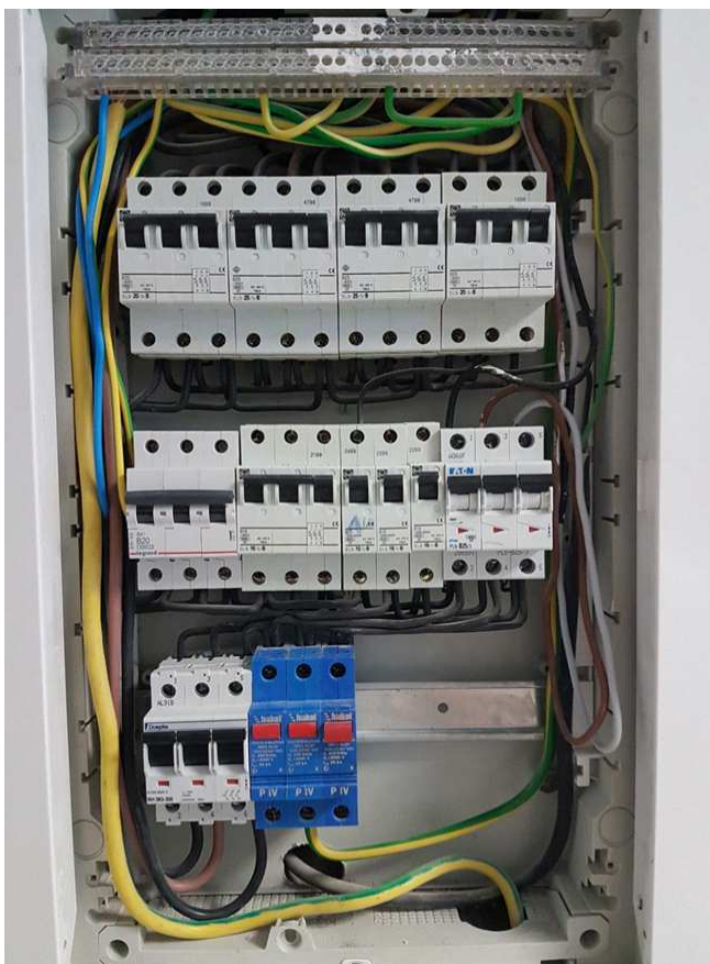
Obr. 4: Nesprávne uzemnenie prepäťovej ochrany. V súbehu vodičov sa pri prepäťi naindukujú napätie
