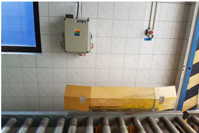
Obr. 3: Zásuvková skriňa a tlačidlo núdzového vypnutia za dopravným pásmom v trojmennej prevádzke
