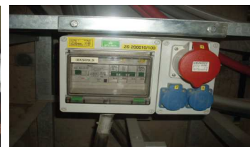
Obr. 2: Příklad zásuvkové skříně v kolektorové síti
